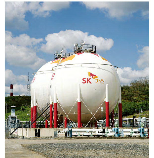
→ 울산 수입기지는 지하에 공동을 건설해 LPG를 저장하는 시설로 지하공동은 프로판 14만 톤, 부탄 13만 톤, 총 27만 톤 저장 규모로 이는 세계 최대 규모였습니다.
